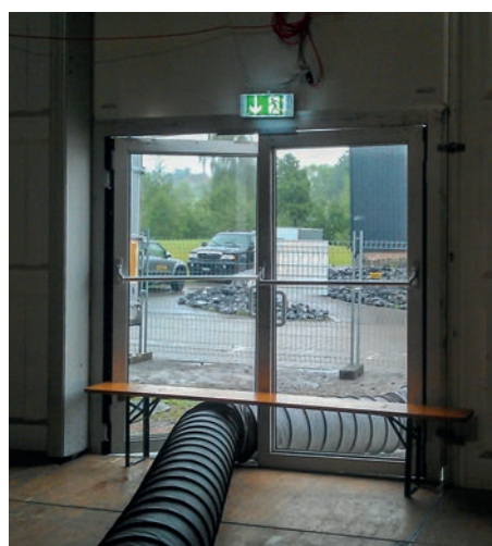
Notausgänge sind stets frei zu halten.
